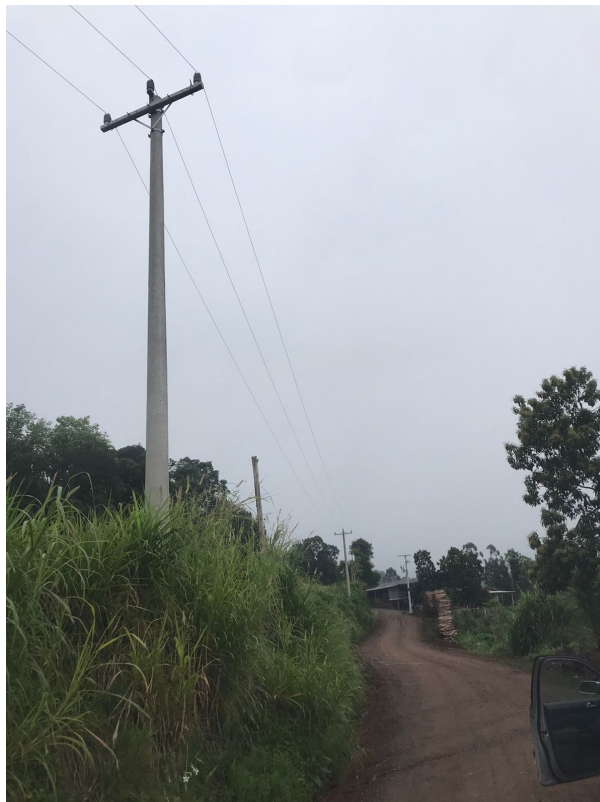
Ponto c – Chapadão – Ponto final da rede
